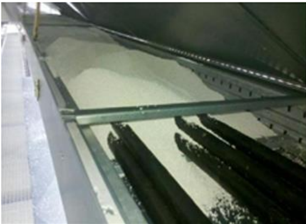
Abbildung A: präventiv geschützter Kabelkanal
